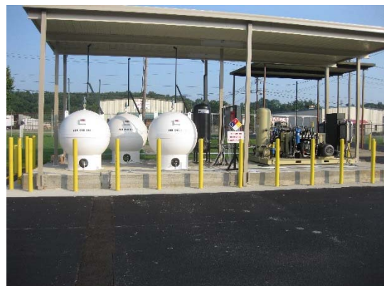
Alagasco WOC CNG- Bessemer, AL
